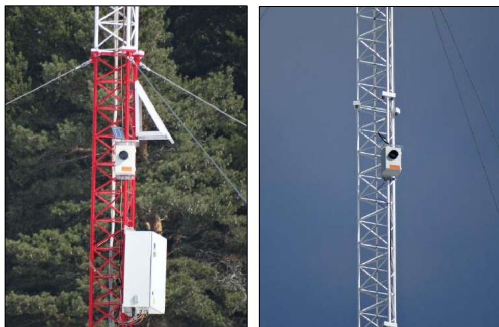
Figure 35 : Clichés du positionnement d'une BCBox sur mât de mesure
